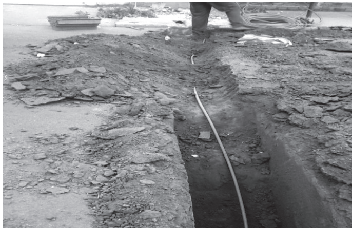
Figura 5 - Extensão de ramal em PEAD da rede ao hidrômetro Fonte: Os autores (2015).
